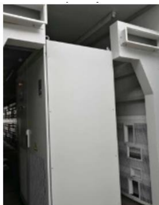
HPS w kontenerze
