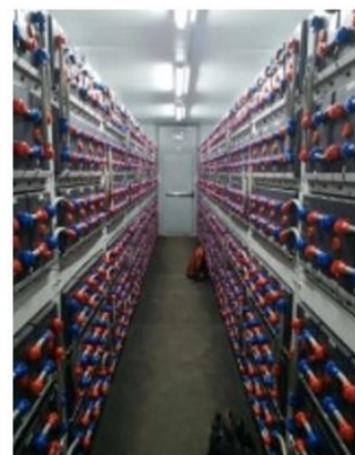
Akumulator w kontenerze
